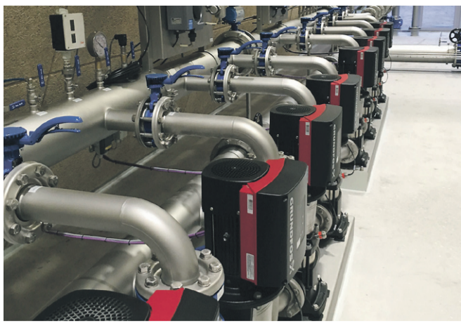
Moderne højeffektive pumper kører det topmoderne anlæg.
