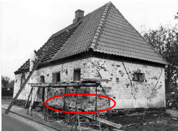
Figur 2. Det gamle hospital under restaurering. Det ses tydeligt at kvadersokkelen ikke går hele vejen rundt om huset. Den røde cirkel markerer den manglende granitsokkel. Efter http://auningby.dk/fileadmin/migrated/pics/Kirkegade-1976_01.jpg
