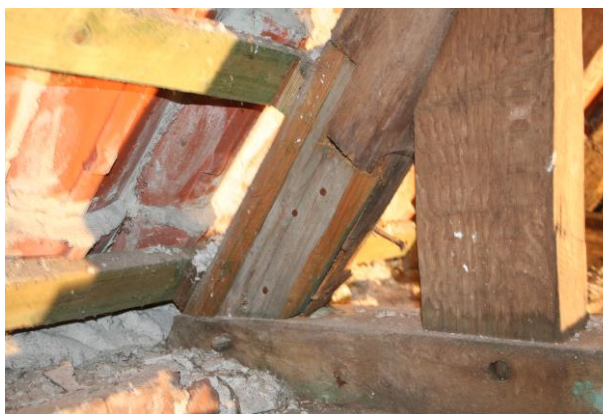
Figur 13 Spærfod med tydelige spor efter ombygning.
