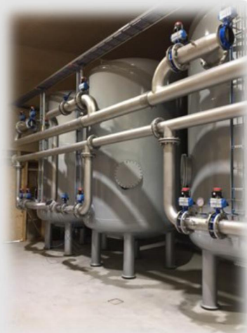
Foto interiør vandværk: Filtre
